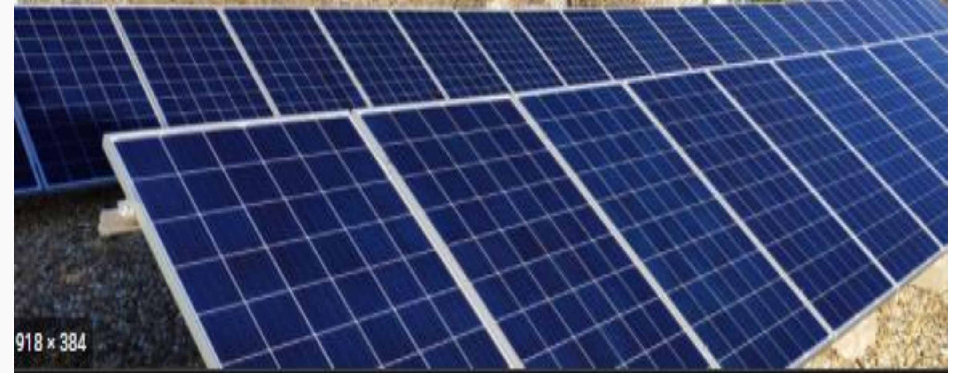
Fig.2 Sistema solar fotovoltaico
